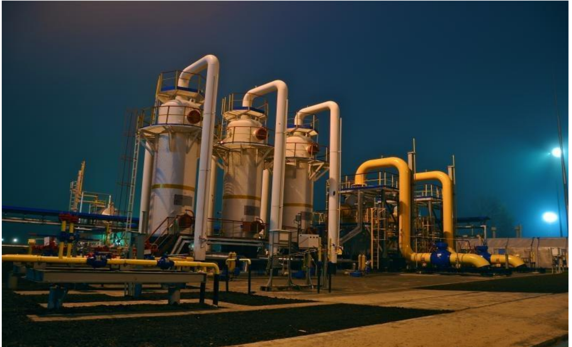
Компрессорная станция (КЦ-1 КС Красноармейская)
